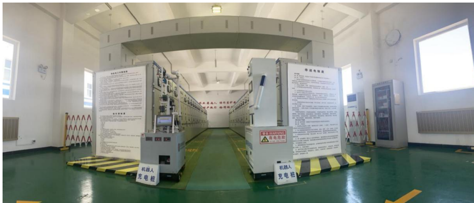
图1 电气开关柜智能操作机器人
