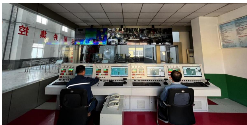
图 1 副井集控室远程监控
