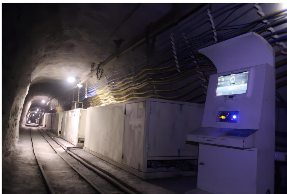
图 2 集成供液系统安装硐室
