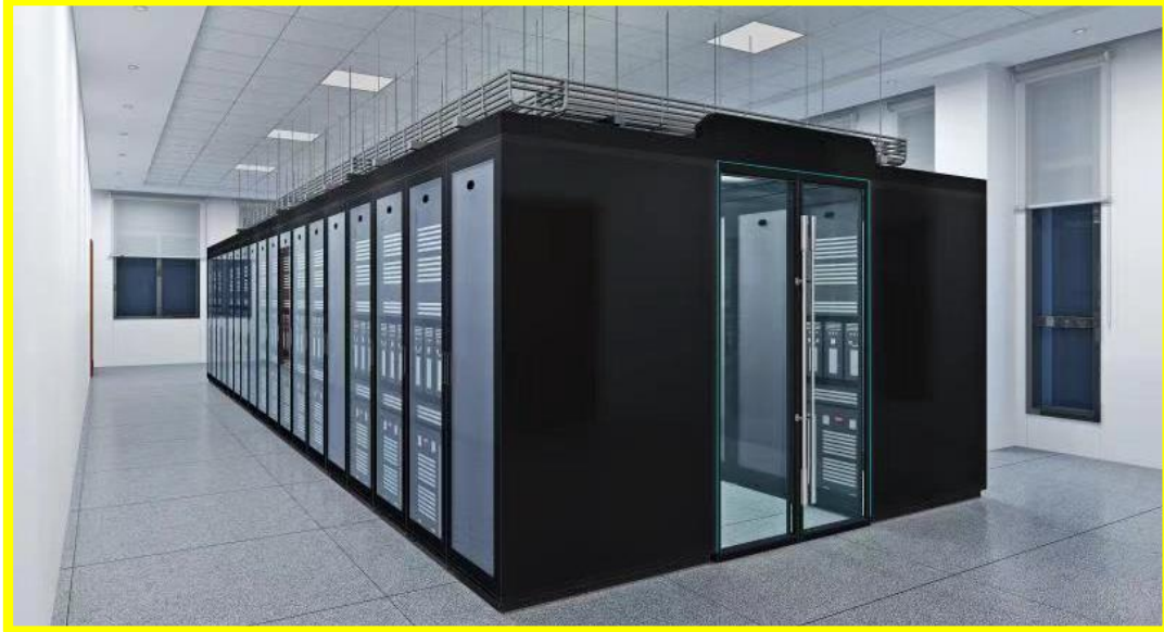
图 3 运行中的微模块数据中心
