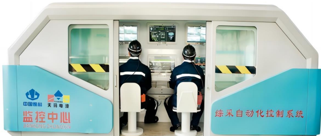
图2 智能综采顺槽集控中心
