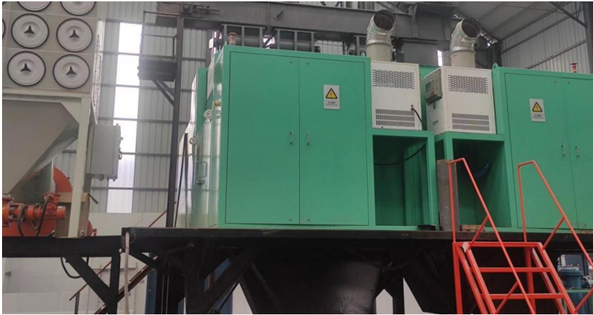
图 2 VCS 智能干式选煤机现场图
