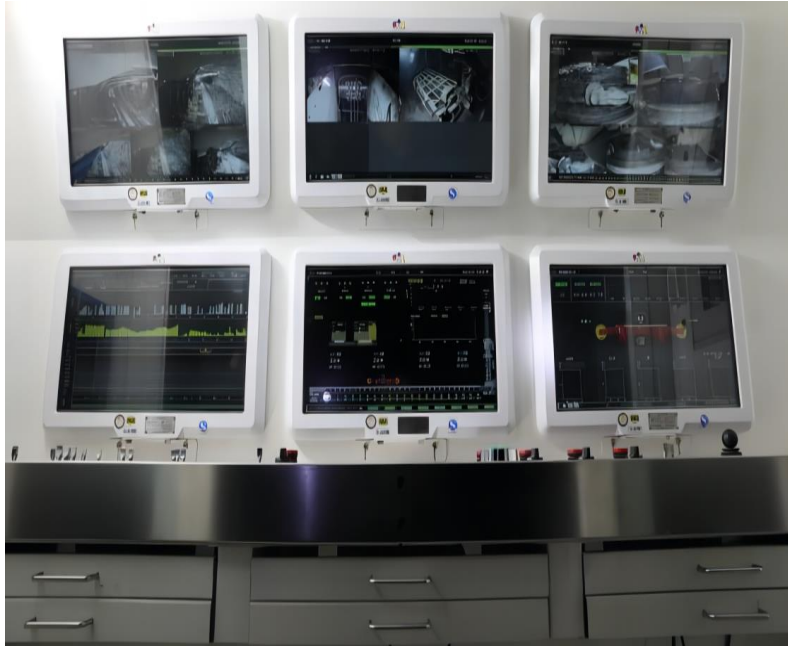
图 4 工作面集中控制室现场监控图
