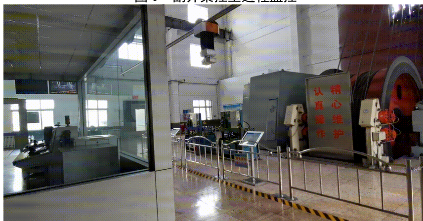
图 2 主井提升机房无人值守
