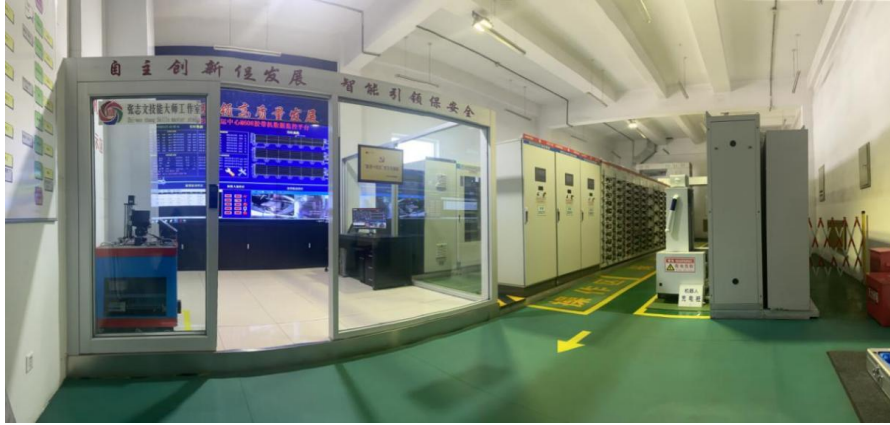
图 2 配电室智能巡检机器人
