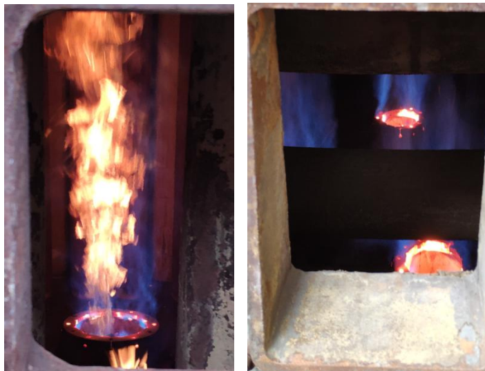
图 2 改造前重整炉和 1#航煤加氢炉燃烧状况
