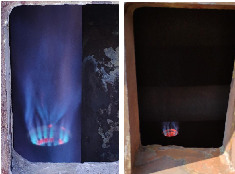
图 3 改造后重整炉和 1#航煤加氢炉燃烧状况
